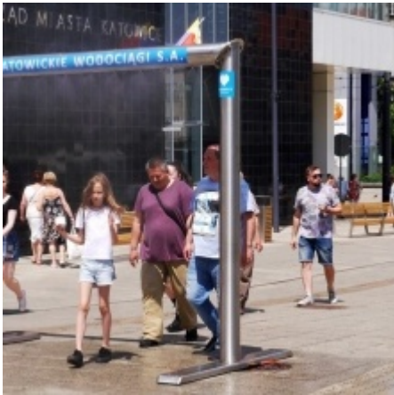
Kurtyny wodne w Katowicach
