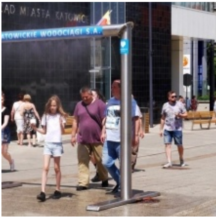
Kurtyny wodne w Katowicach
