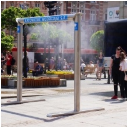
Kurtyny wodne w Katowicach
